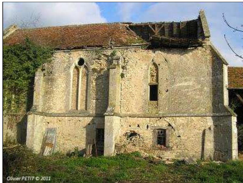
La chapelle du Libdeau est en train de s'effondrer (Crédits photo : Olivier Petit)
