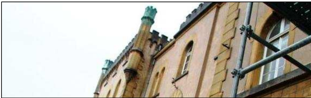
Le Palais Cambout est en péril à Metz.
